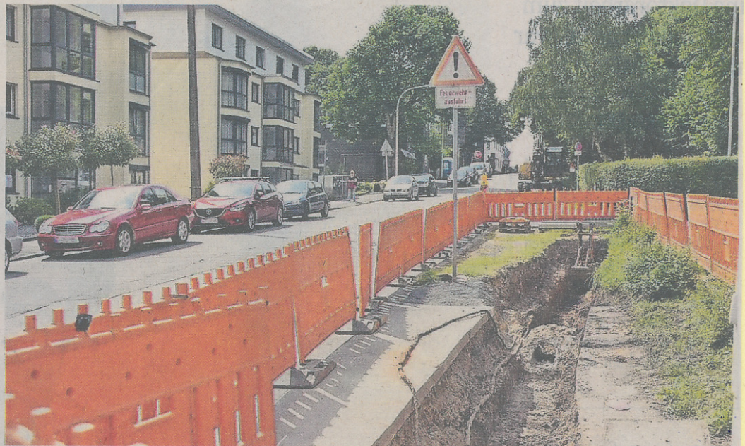
Seit Jahren ist die Kemmannstraße Baustelle - und wird es erst einmal bleiben.
