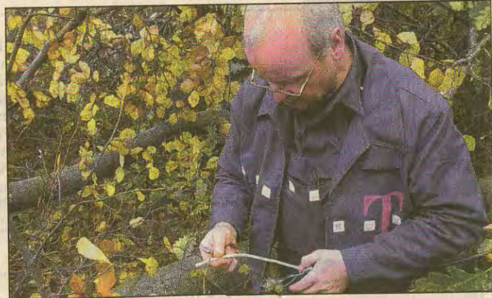
Ungewöhnlicher Arbeitsplatz: Auf Tuchfühlung mit einem umgestürzten Baum ging dieser Mitarbeiter der Telekom gestern am Westfalenweg. Der Sturm hat mehrere Leitungen, die oberirdisch verlaufen, in Mitleidenschaft gezogen. Foto: Andreas Fischer
