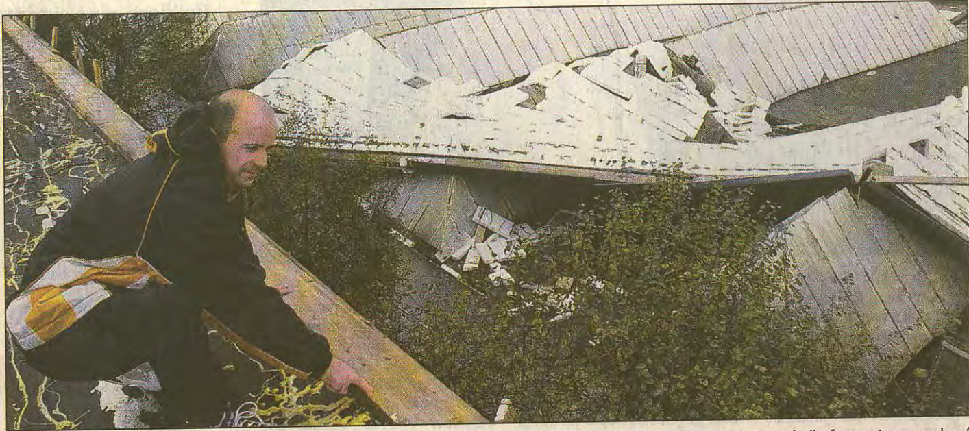
Hier fehlt das Dach: Am Sportpark Vohwinkel wurde die 500 Quadratmeter große Abdeckung der Badmintonhalle fortgerissen und auf angrenzende Gebäude geschleudert. Geschätzter Schaden: rund 35 000 Euro. Foto: Kurt Keil
