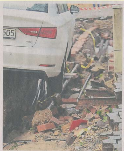
An der Tannenstraße wurde der Bürgersteig unter parkenden Autos weggespült.
