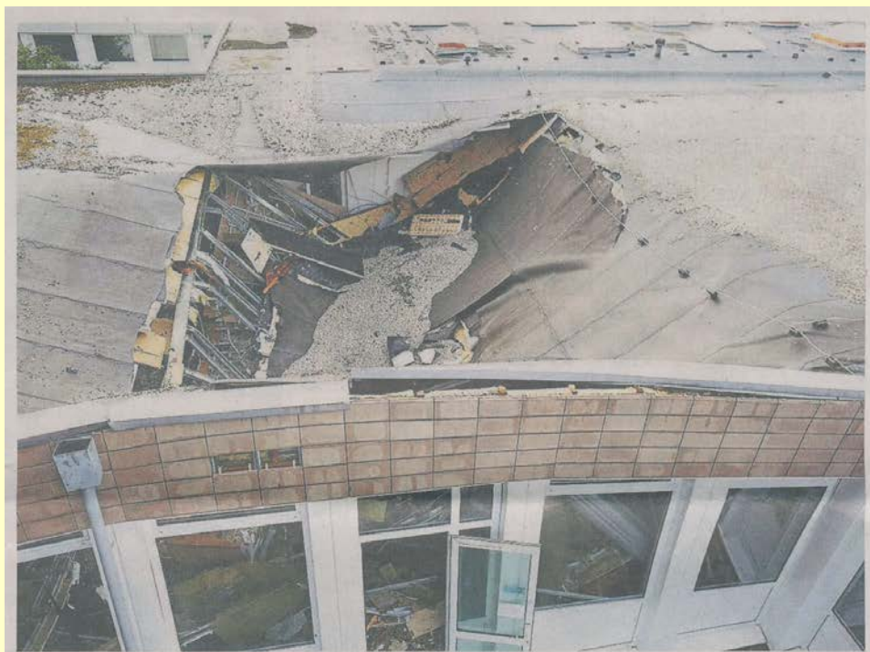
Am Campus Haspel stürzte an einem der älteren Gebäude ein Dach ein.
