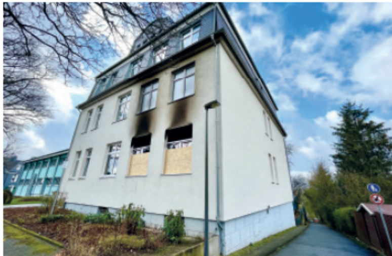
Wie im CW-Bild zu sehen: Schauplatz des Brandes war ein Büro im rechten Erdgeschoss der Hermann-Herberts-Grundschule am Cronenfeld.
