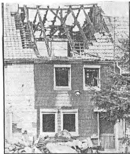
Verkohlte Dachbalken, Fenster platzten in der Hitze des Feuers. Das Traumhaus von Maler Helmut B. brannte aus.
