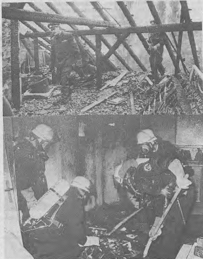
Vollkommen zerstört wurde gestern der Dachstuhl eines Hauses an der Anhalter Straße. An der Alsenstraße brannte eine Wohnung aus.
