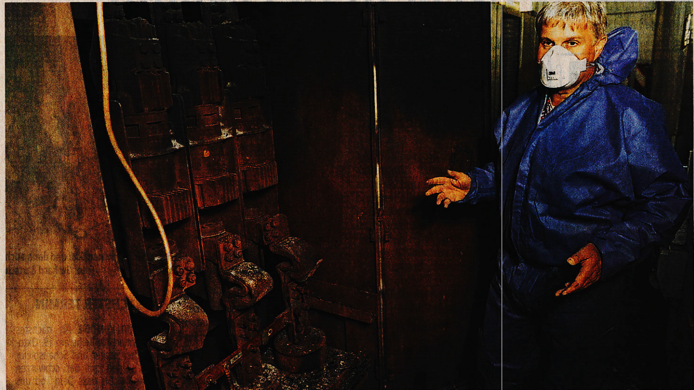
Nur mit Mundschutz: Udo Kadach von den WSW untersuchte gestern die Unglücksstelle im Umspannwerk an der Küllenhahner Straße.
